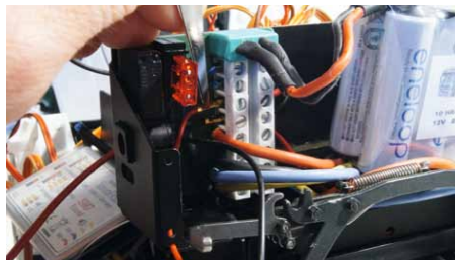
Die Elektroverteilung im ScaleART-Actros bietet noch freie Schnittstellen, um die Spannungsversorgung des SM7 sicherzustellen
